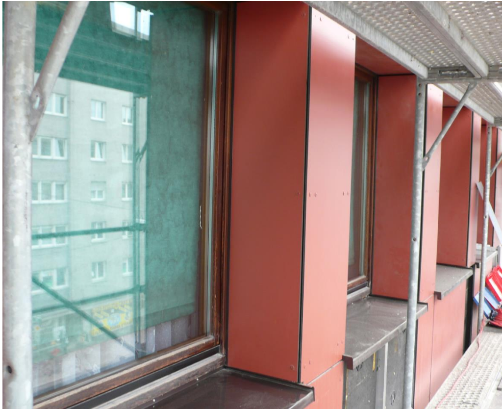
Fassade und Fensterlaibung ohne Fassadenprofile.
